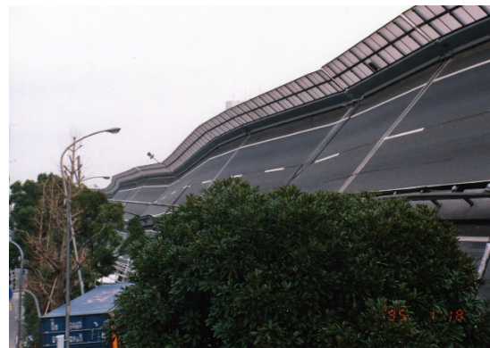
[神戸市東灘区 阪神高速倒壊現場]
